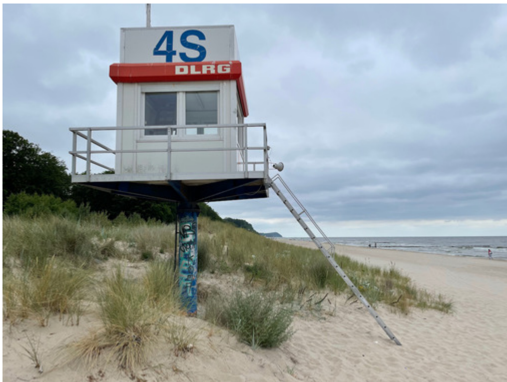
Ostturm mit angestellter Leiter. Infolge des angewehten Sandes kann die Leiter nur sehr flach angestellt werden und biegt sich beim Besteigen mit schwererer Ausrüstung durch.
