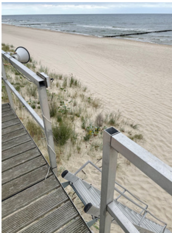
Fehlende Absturzsicherung am Ostturm
