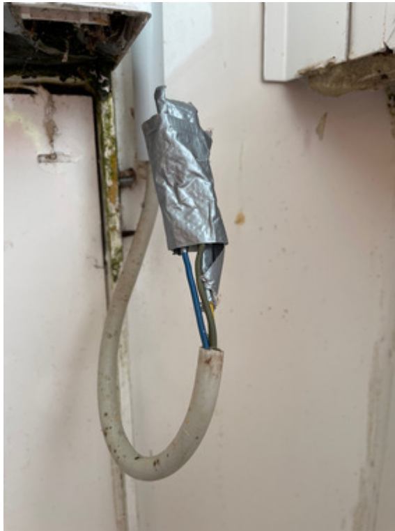
Nicht fachgerecht verlegter Elektroanschluss
