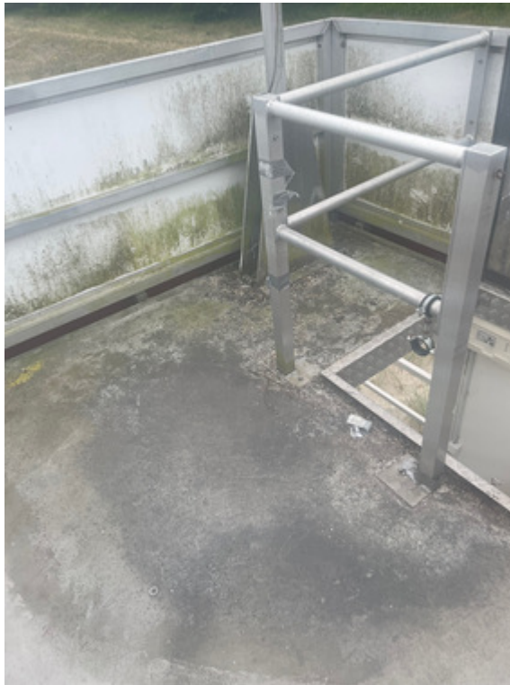
Verwitterter Ausguck am Ostturm
