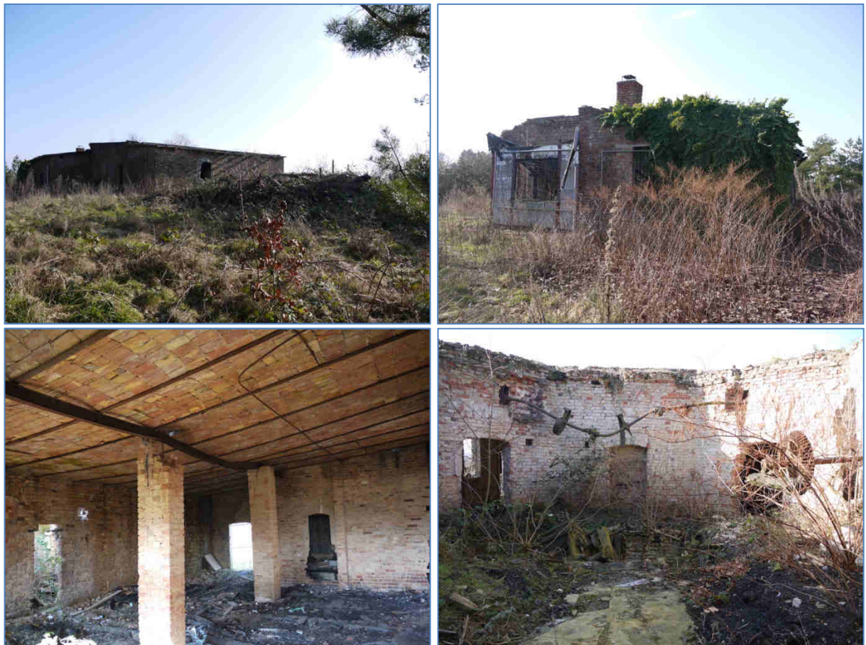
Abb. 4 bis 7 Ansichten des ruinösen Gebäudebestandes
